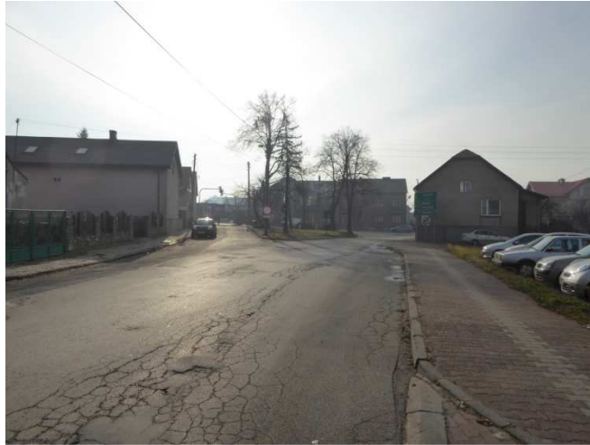
Rys. 12.1 Zły stan nawierzchni na analizowanej ulicy Krakowskiej
